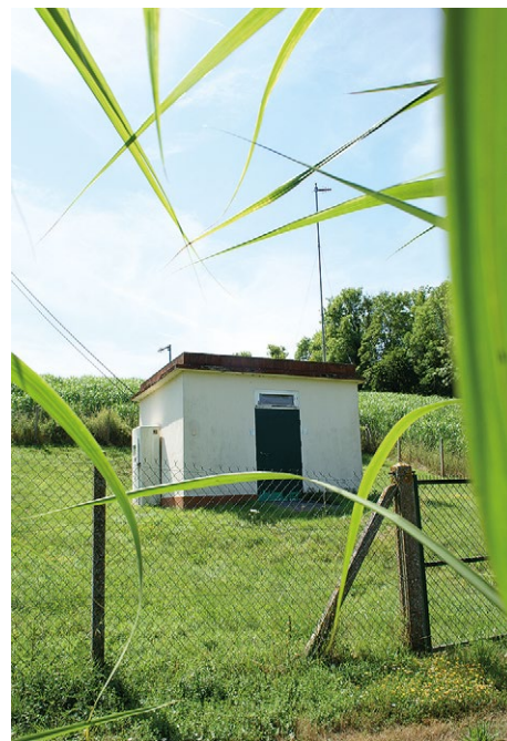
Captage d'eau potable
