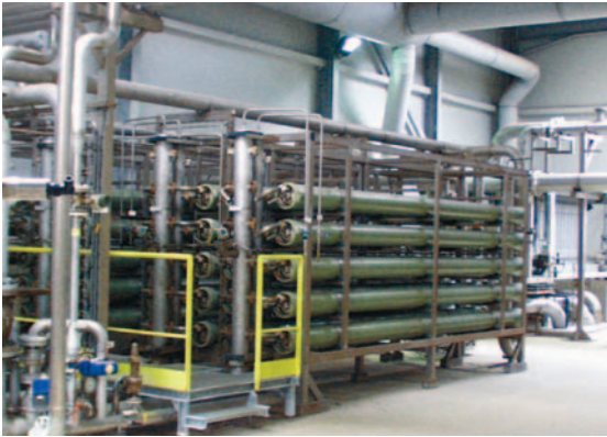
Installation d'osmose inverse (1 er plan) + micro-filtration
