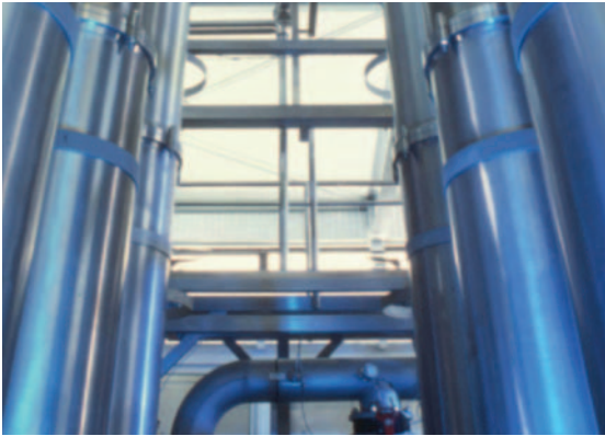
La salle des membranes de l'unité BRM
