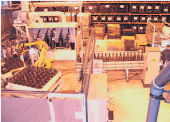
Vue générale de l'installation
