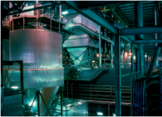
L'unité de valorisation énergétique VESTA du SMEDAR, située à Grand-Quevilly
