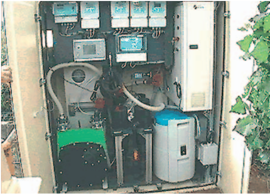
Station de mesure installée par Haganis pour contrôler l'effluent en temps réel
